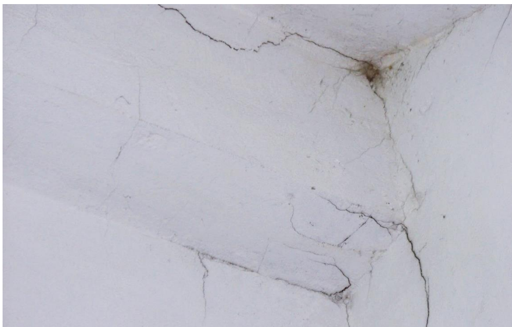
Fot.14 i 15 Na ścianie zachodniej pomieszczenia 04A rysa pozioma przy suficie,
