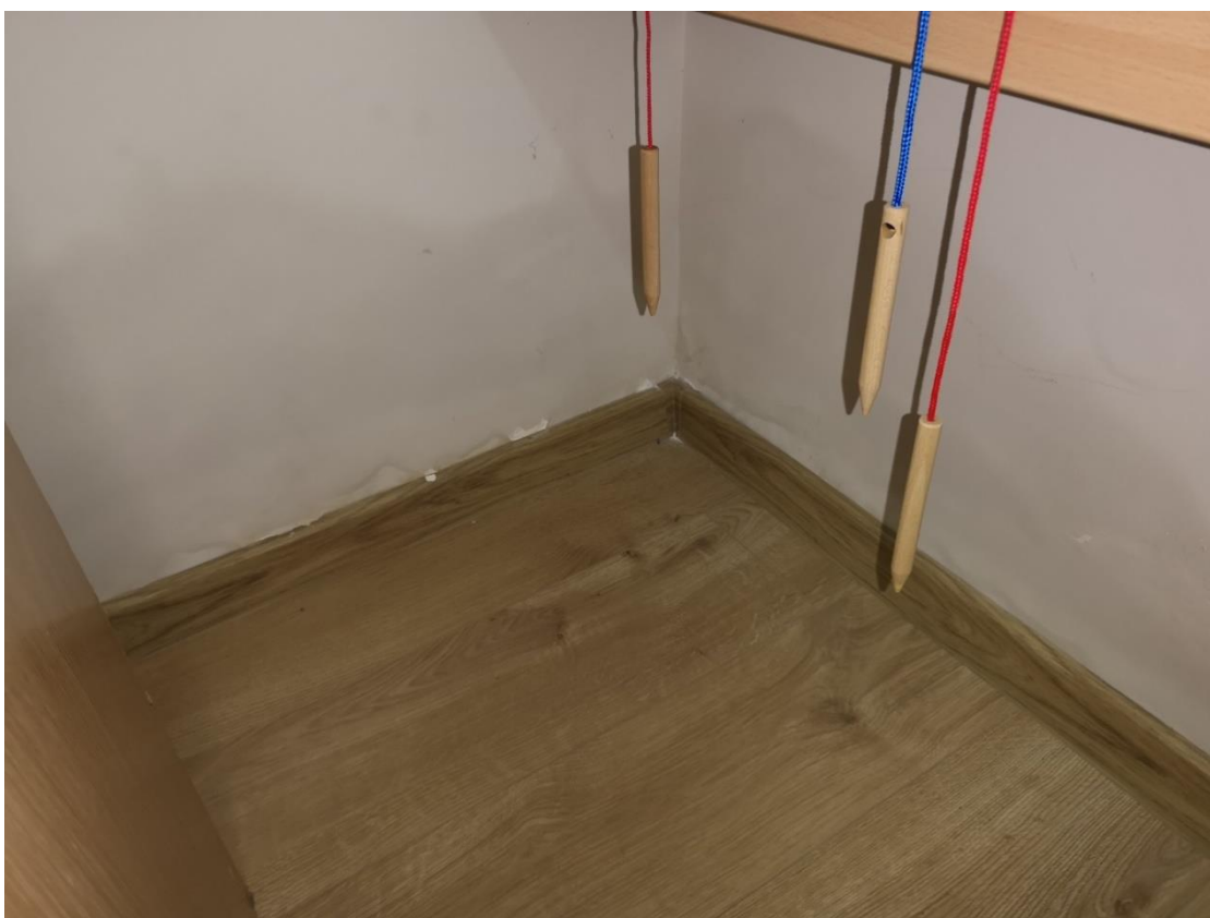
Fot.3 Linia zawilgocenia w dolnej partii ścian pomieszczenia 06 przy narożniku południowo-zachodnim
