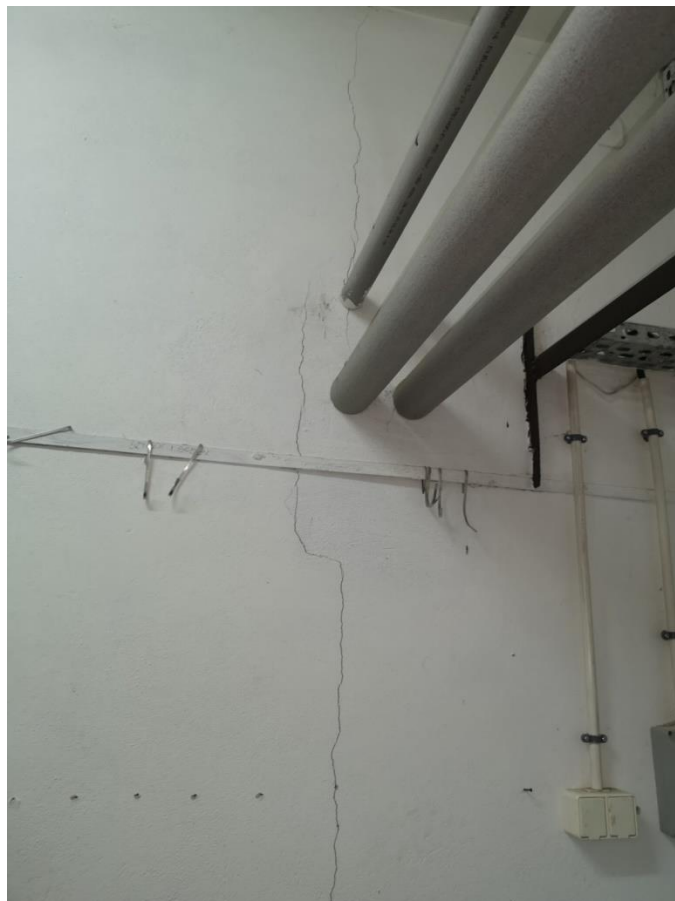
Fot.11 Pomieszczenie 019 rysy przy przepuszczeniu rur
