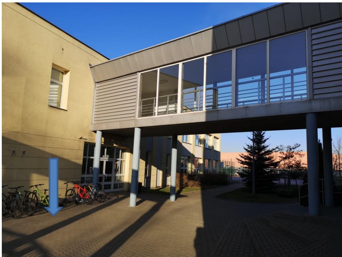
Fot. 22 Widok łącznika i miejsca silnego osiadania gruntu od strony wschodniej Małej Szkoły (strzałka)
