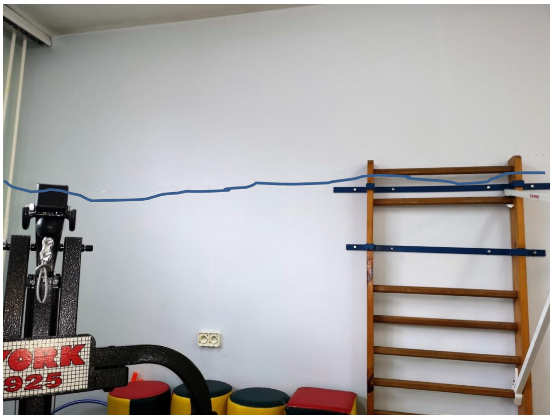
Fot.5 Pozioma rysa w ścianie zachodniej pomieszczenia 10
