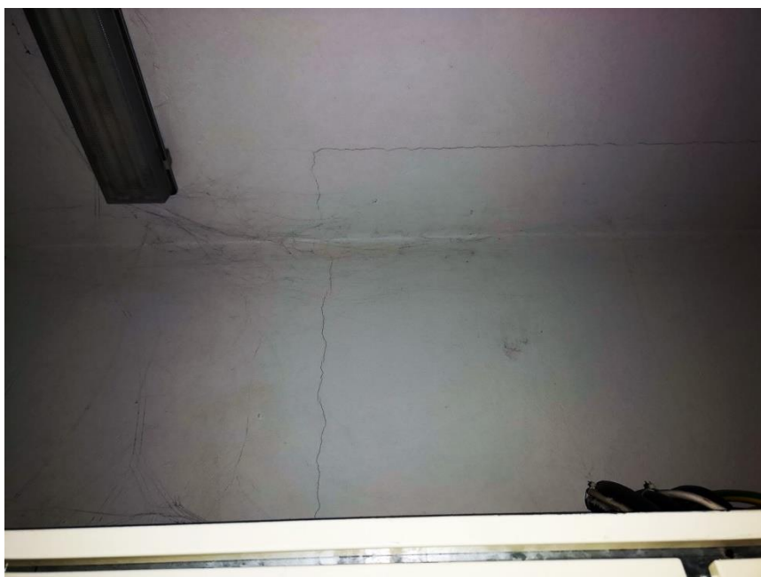
Fot. 8 Rysa w ścianie i suficie w pomieszczeniu 011
