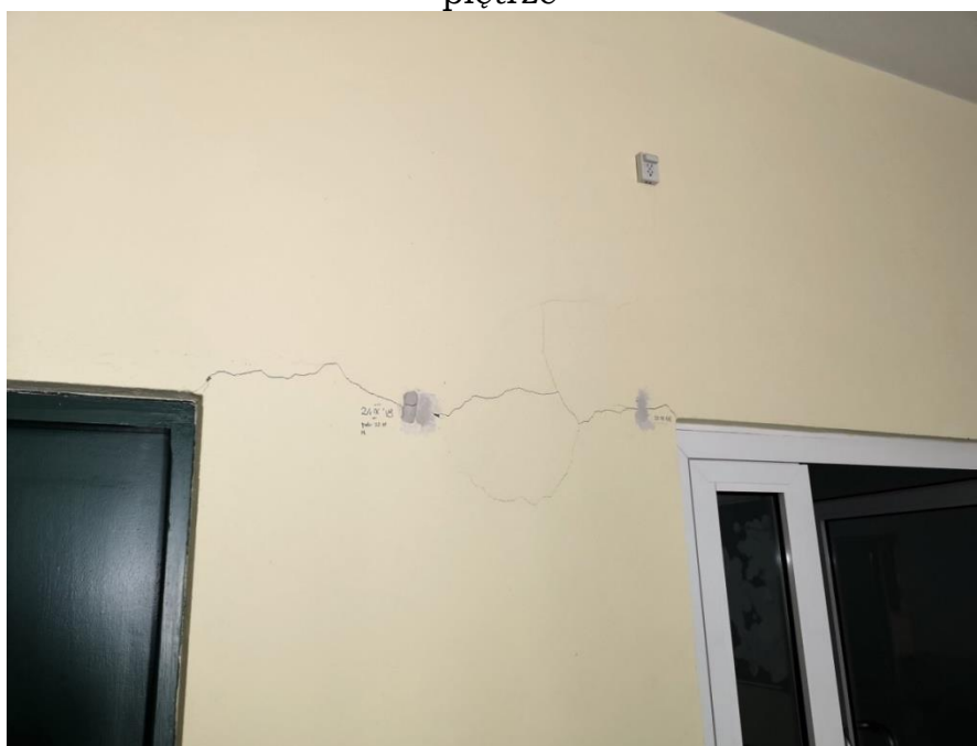
Fot. 19 Pozioma rysa o rozwartości 0,32 mm, która została zaobserwowana po raz pierwszy wiosną 2018 roku; plomba gipsowa dwukrotnie pękła
