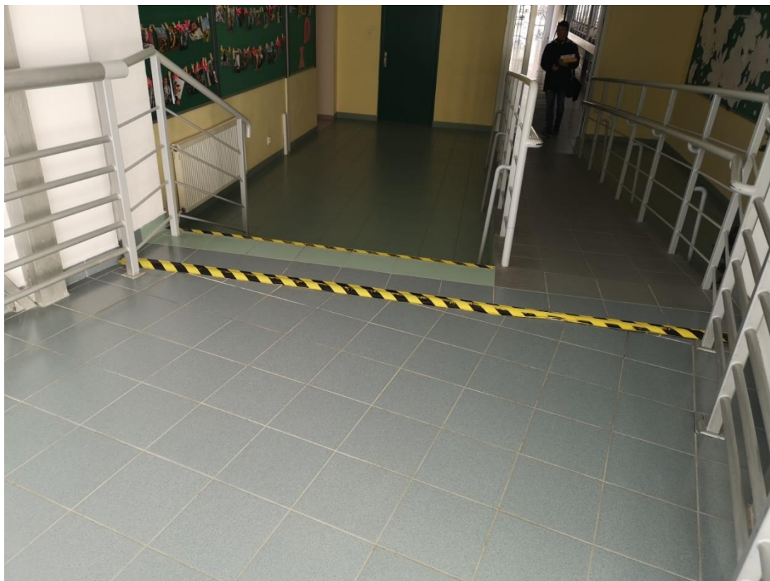
Fot. 20 Różnica poziomów 3- 4,5 cm pomiędzy łącznikiem a stropem nad I piętrzem powiększająca się od 6-7 lat.
