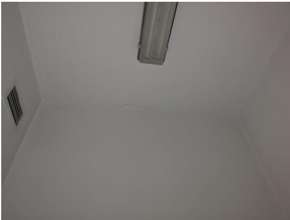
Fot.9 Rysa na styku ściany i sufitu w pomieszczeniu 012B
