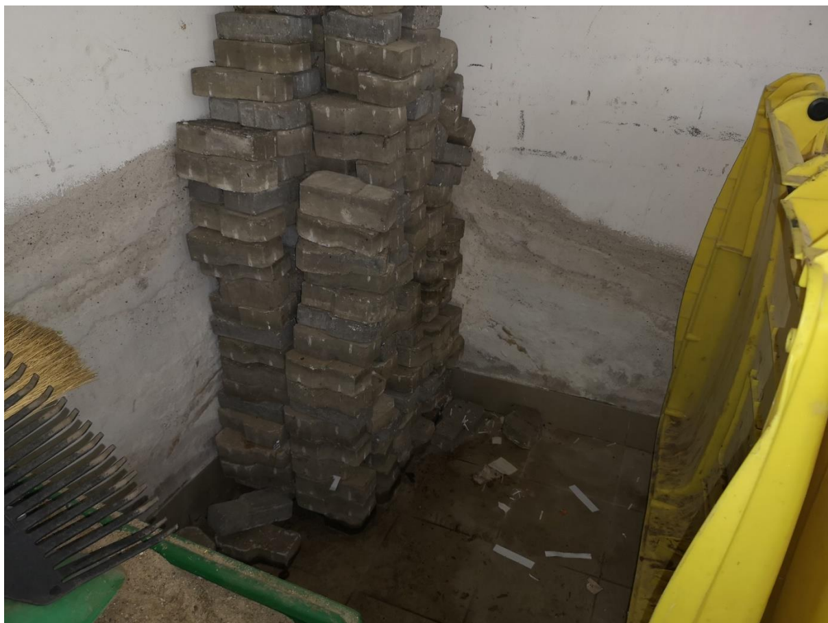
Fot.17 Śmietnik wewnętrzny - pomieszczenie 017; korozja tynku spowodowana zasoleniem ściany na skutek składowania piasku z solą do posypywania chodników w zimie
