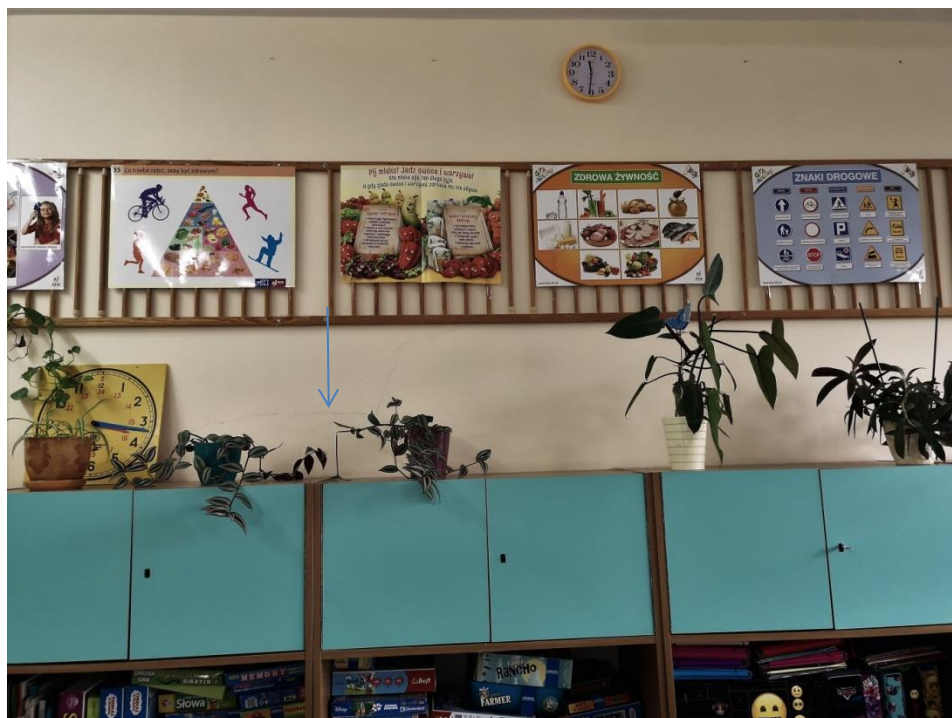
Fot.13 Ukośna rysa na ścianie wschodniej w pomieszczeniu 3B
