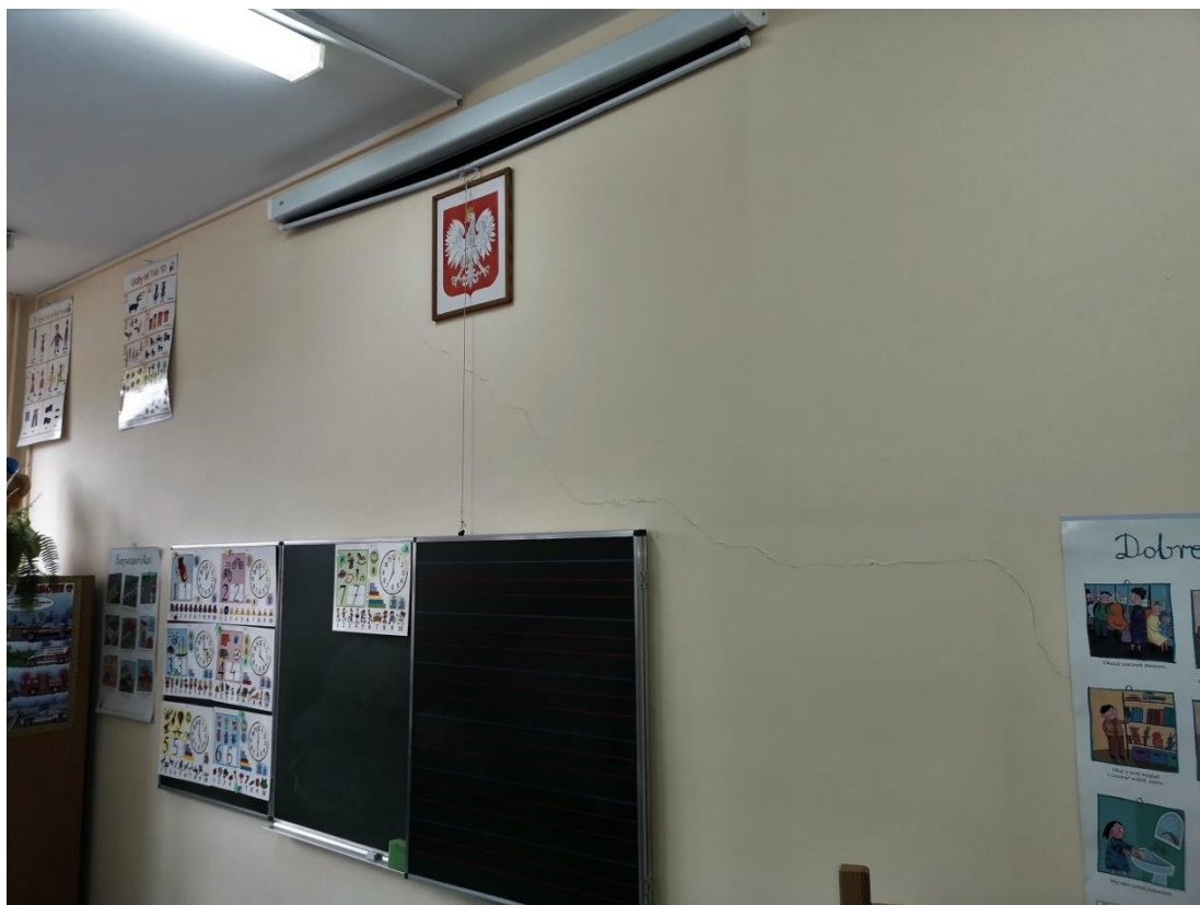
Fot.12 Ukośna rysa w ścianie zachodniej pomieszczenia lekcyjnego 2B o szerokości rozwarcia od 0,35 mm
