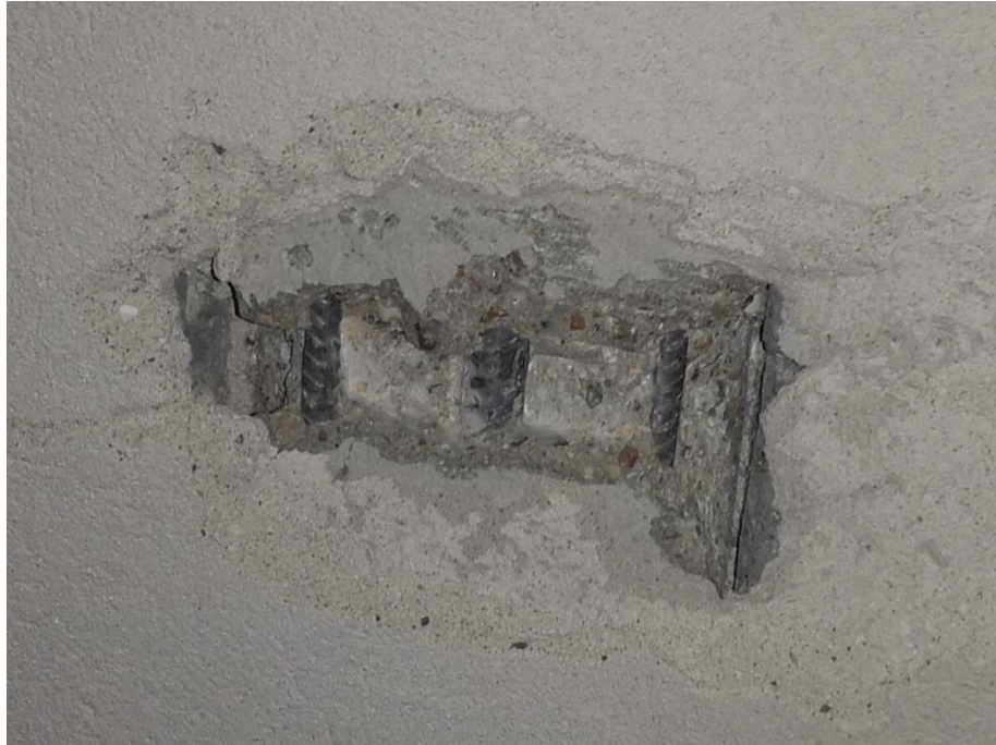
Fot. 23 Odkrywka prętów zbrojeniowych w belce stropu nad parterem pod zarysowaną ścianą działową: 2 Ø8 mm + 1 Ø14 mm
