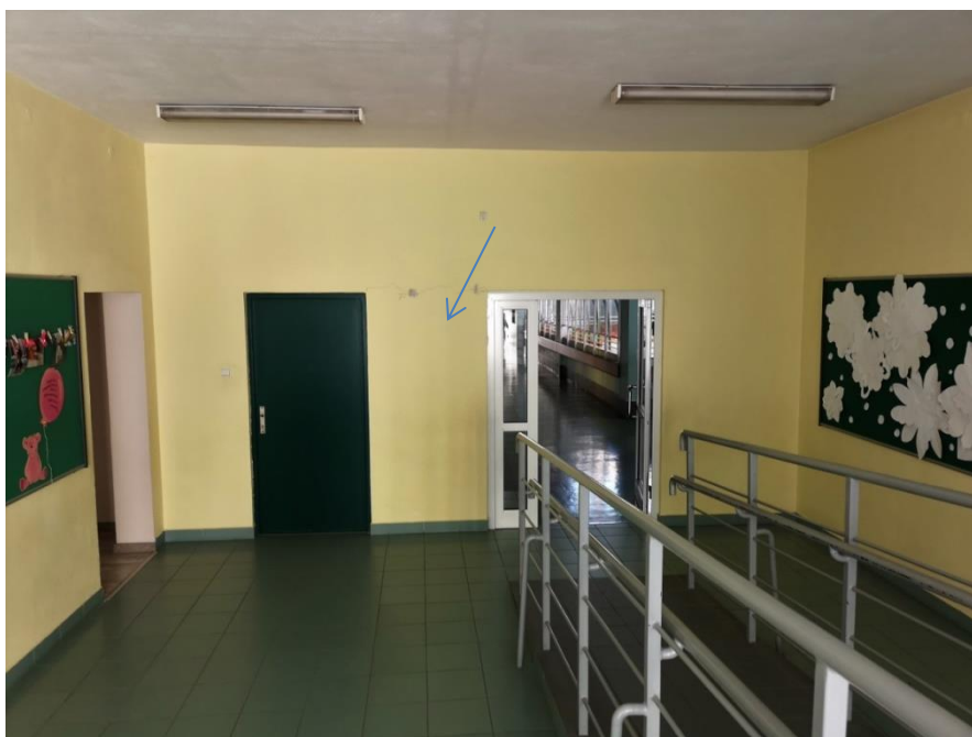
Fot. 18 Poziome pęknięcie filarka między drzwiowego w ścianie działowej na I piętrze
