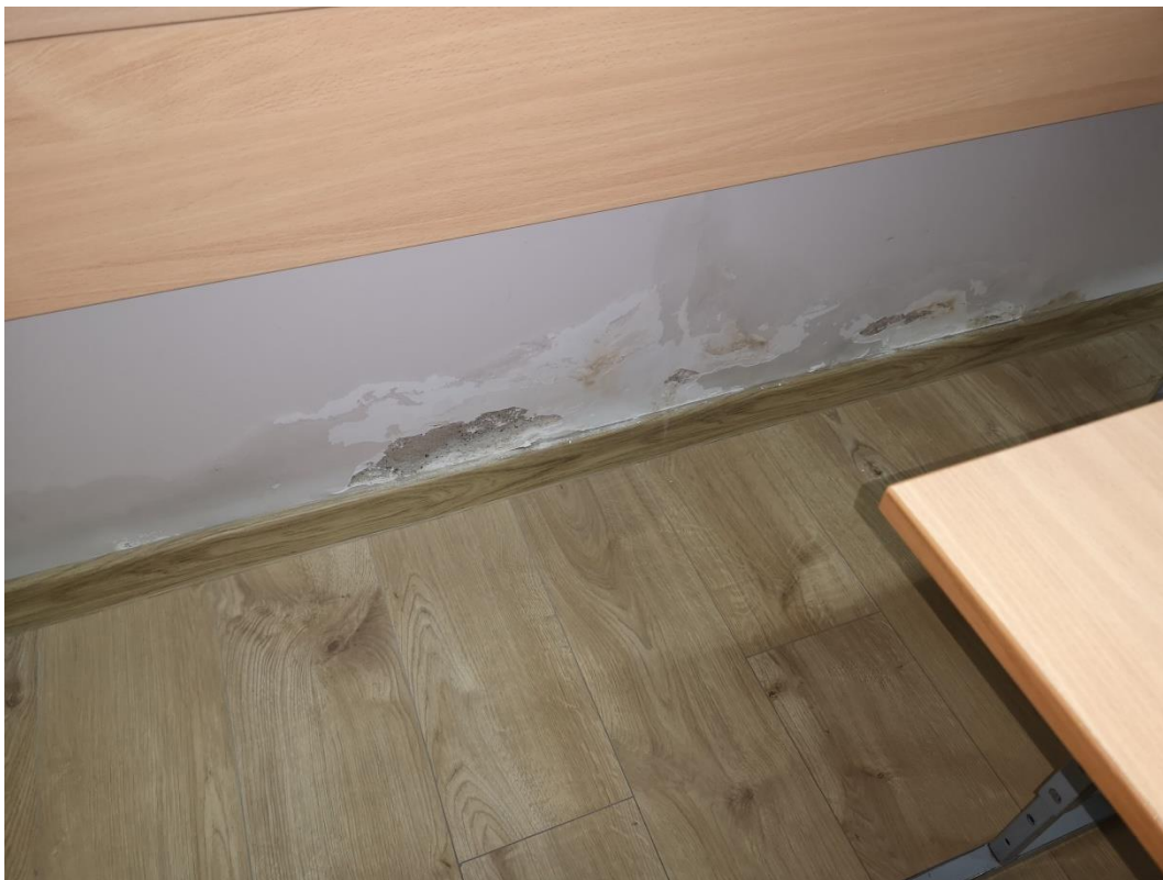
Fot.2 Odpadanie tynku i wykwyty solne w dolnej partii ściany zachodniej w pomieszczeniu nr 06
