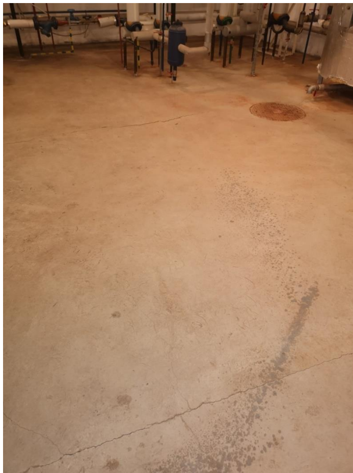
Fot.10 Rysy w posadzce pomieszczeniu 018
