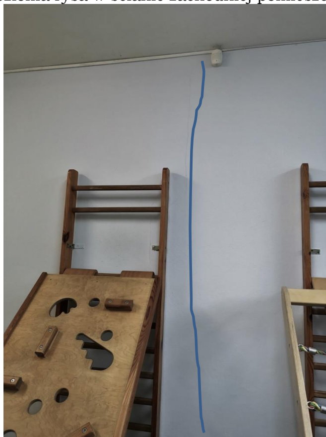
Fot.6 Pionowa rysa w ścianie północnej pomieszczenia 010
