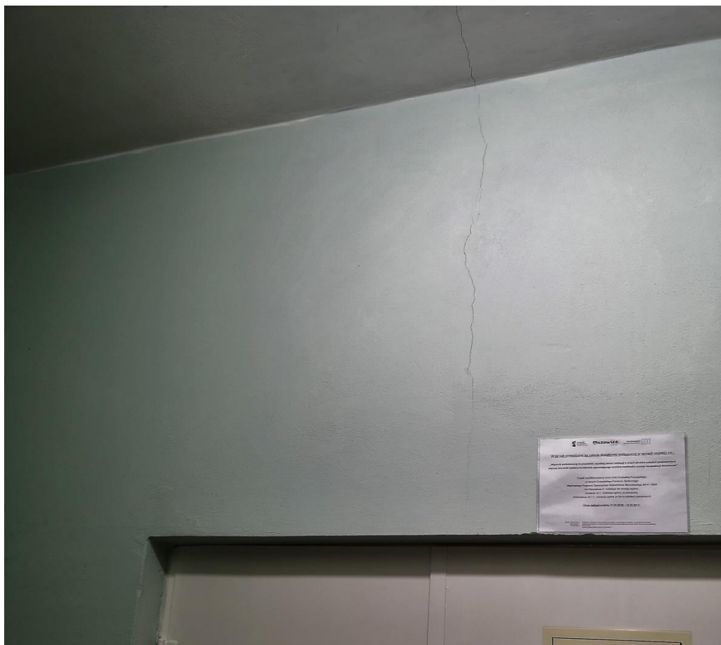
Fot.1 Pionowa rysa w ścianie korytarza 01 w piwnicy nad drzwiami do pracowni jęz. Angielskiego
